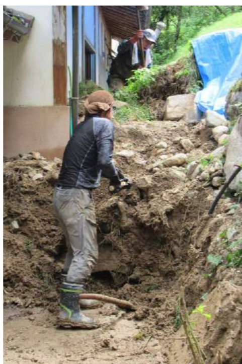
大量の土砂が屋内に流入
